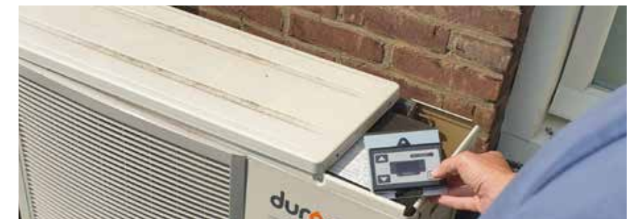
Afhankelijk van de energiebehoefte in de woning, worden buiten één of twee monoblock buitenunits geïnstalleerd.
